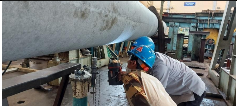
Gambar 3. Pengecekan crack menggunakan crack meter
